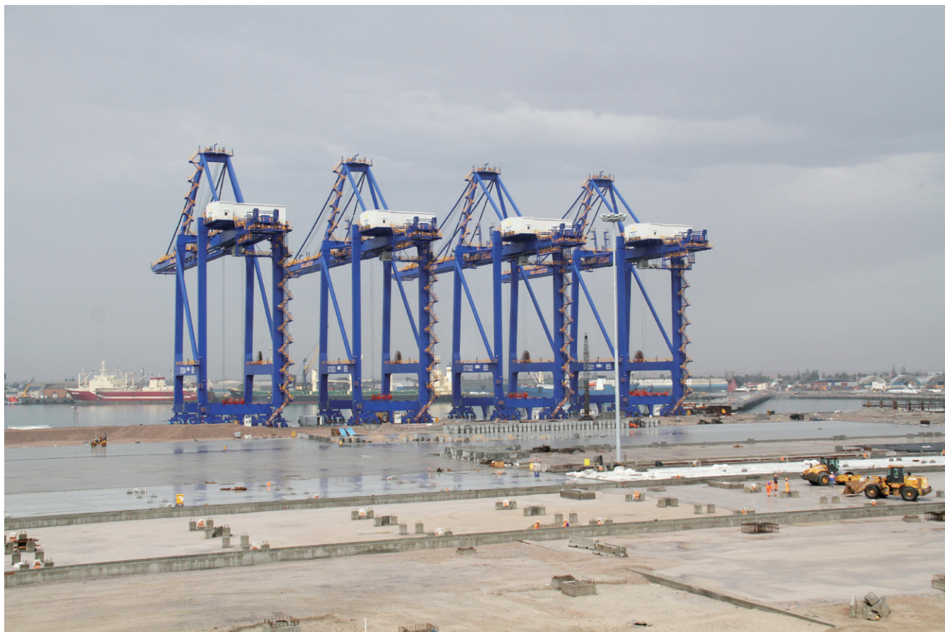
“正确义利观”的本质内涵是“用中国发展助力非洲的发展，最终实现互利共赢、共同发展”。为了助力非洲发展，中国港湾工程有限责任公司（中国港湾）在纳米比亚沃尔维斯湾港吹填了40万平方米的人工岛，为港口建设新集装箱码头。项目建成后，沃尔维斯湾港年集装箱吞吐量将从现在的30万标箱提升至75万标箱。图为纳米比亚沃尔维斯湾港集装箱码头的四台岸桥。
